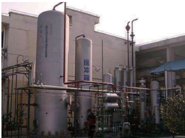
工业副产氢气提纯示范装置
