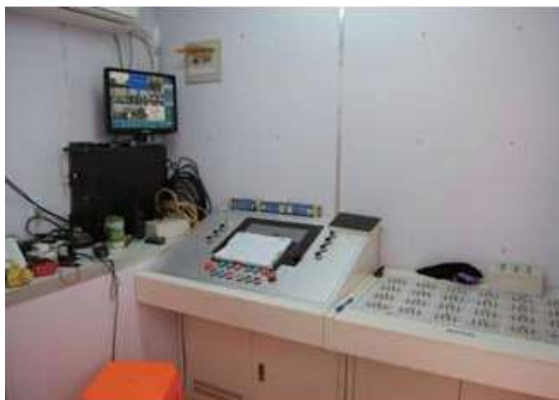
(d) 远程控制室
