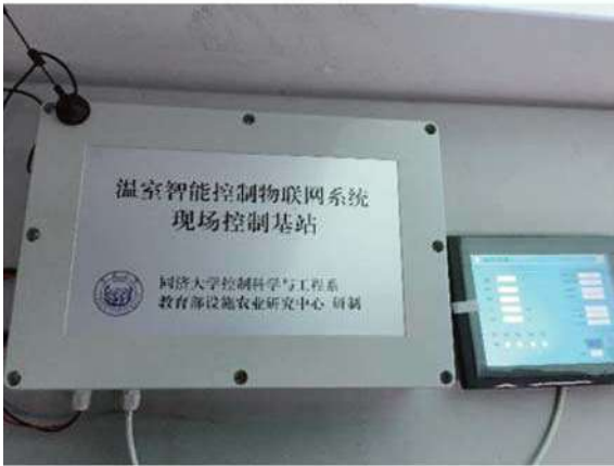
现场控制基站实物
