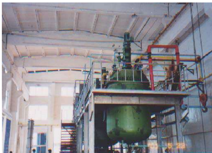
水处理药剂生产线
